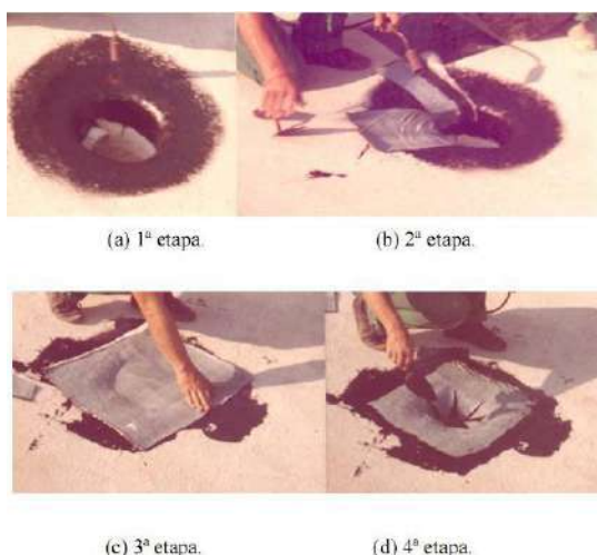
Figura –Impermeabilização junto ao ralo.
